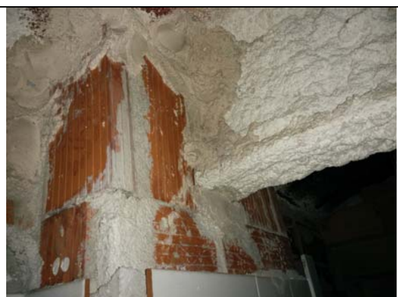
Pilar revestit amb fàbrica i jàssera amb morter de protecció en front al foc
